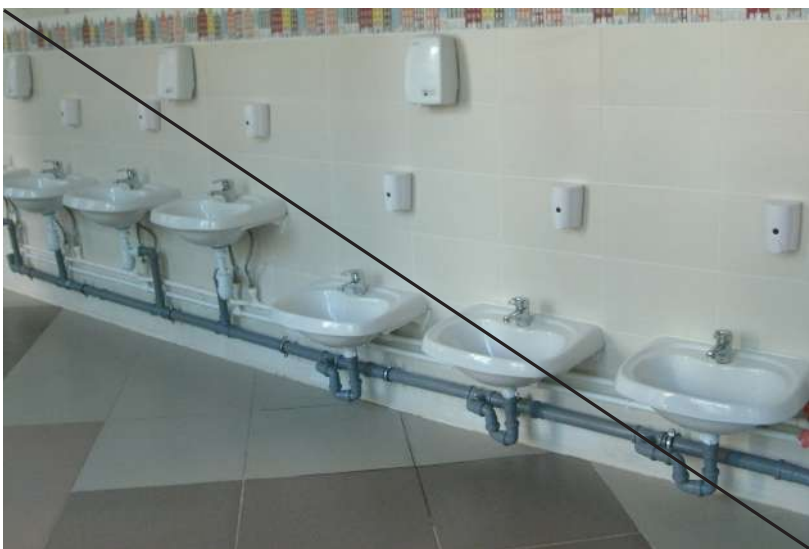
Открытые неаккуратные коммуникации визуально портят гигиеническую зону, собирают пыль и требуют постоянной чистки
